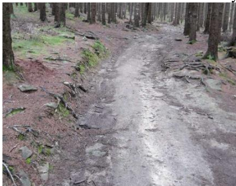
Obrázek 2: Fotodokumentace erozní rýhy
